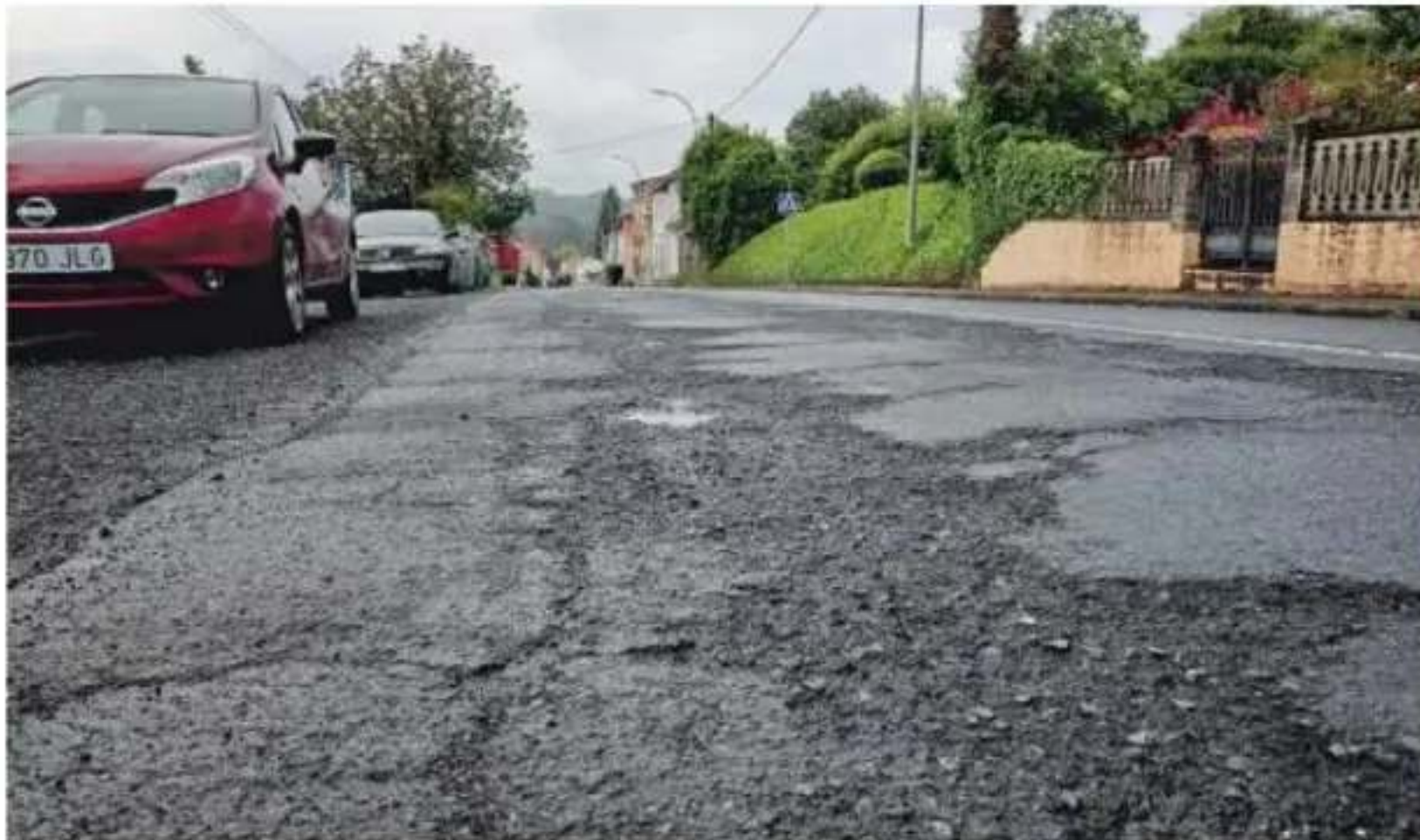
Bergondo. La carretera AC-161, que conecta Betanzos con Sada, tiene uno de los tramos más castigados de la red autonómica, en particular, en el trecho de subida que va desde el límite municipal de Bergondo hacia la glorieta de Los Condes, a la altura de Cruz de Sar. CÉSAR QUIJAN
