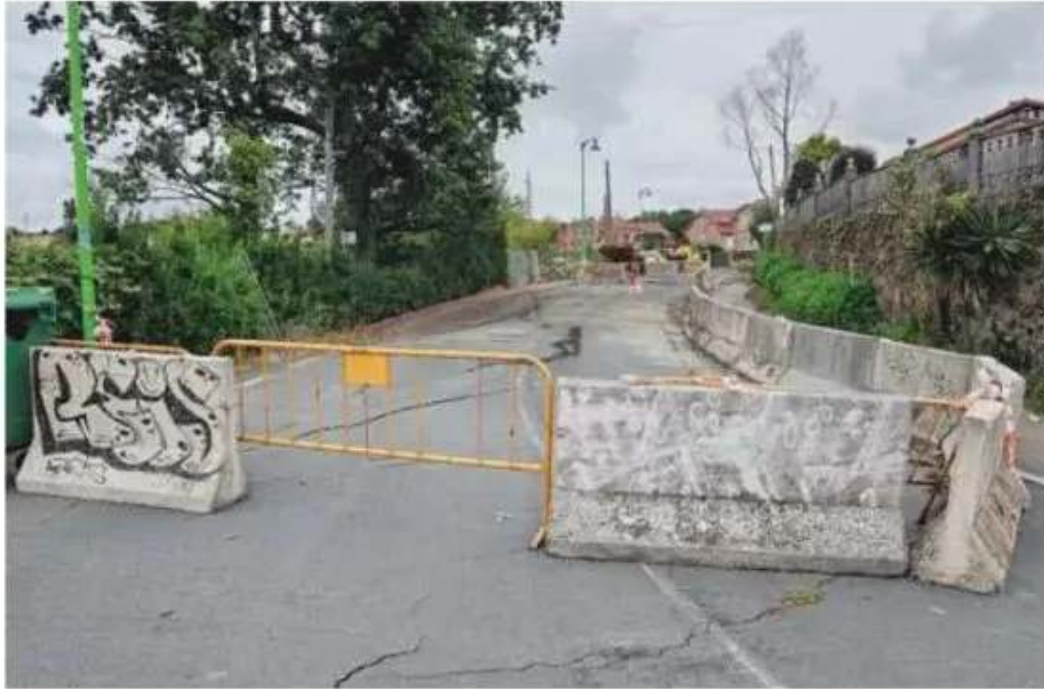
Miño. La DP-4803 que comunica Miño con Perbes está cerrada desde finales de febrero, cuando se abrieron unas grietas en el terreno, que se hundió por un corrimiento de tierras. CÉSAR QUIJAN
