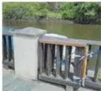
Una de las barandillas rotas que esperan su reparación.
