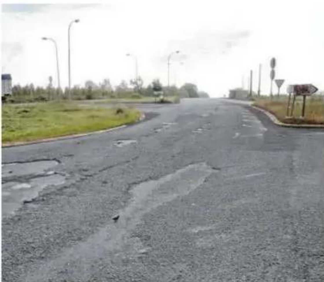
operarios acondicionaron el tramo de Teixeira, donde el tránsito era ya muy socavones a la altura de la rotonda de entrada al núcleo de Curtis. CÉSAR QUIAN
